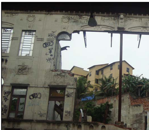
Vista de um prédio em ruínas
